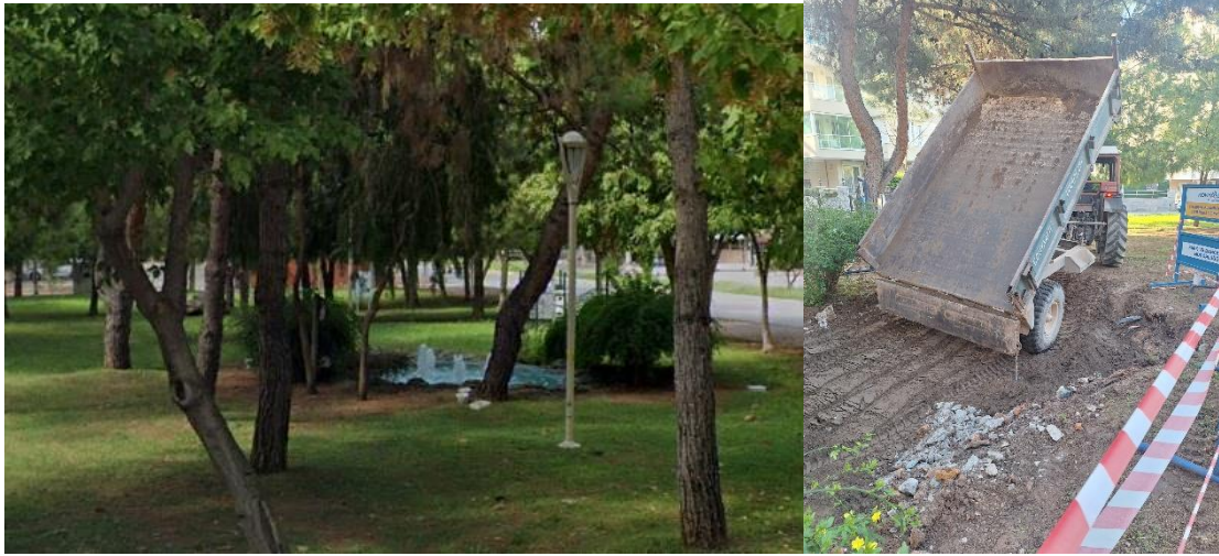
Gürsu Mahallesi Anadolu Cad./345 Sk. keşişimi park alanı süs havuzu dönüştürme çalışmaları
